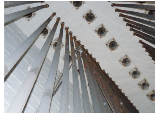
Controllo tubi di reforming tramite LEO-Scan
